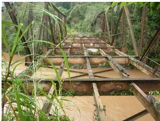
Ponte já abandonada
